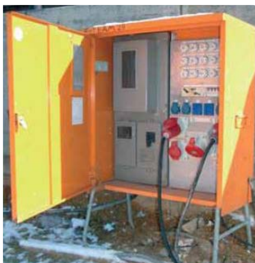
Abb. 66: Fehlerstromschutzschalter im Baustromverteiler, Foto: W. Dohmen
